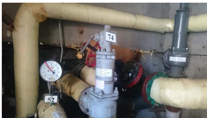
Рис. 2. Пример выполнения присоединения предохранительных клапанов в одном из ЦТП г. Омска
