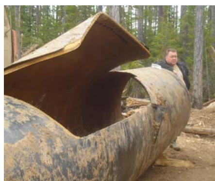
Рис. 6. Разрыв трубы после гидроиспытаний на трассе
