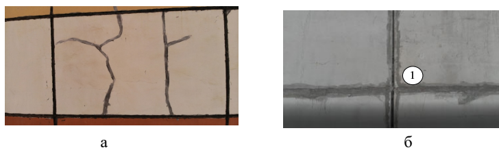
Рис. 6. Изображения для проведения вычислительного эксперимента: а – панель жилого дома; б – панель промышленного здания ПАО «ММК» (1 – пример разрушения соединительных швов)
